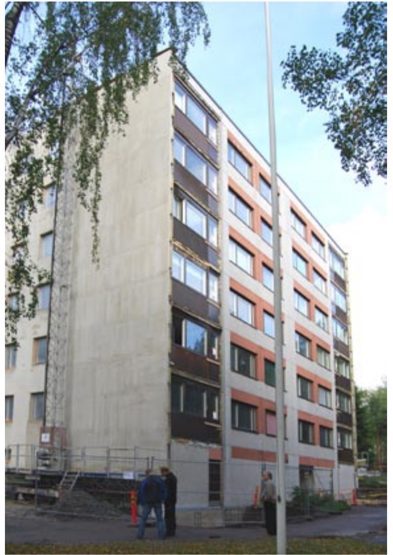
Työnjohtaja Markku Ryyänen odottelee asunto-osakeyhtiö Mikkolanhoiviin uusia parveke-elementtejä, anturat on jo valettu valmiiksi.
