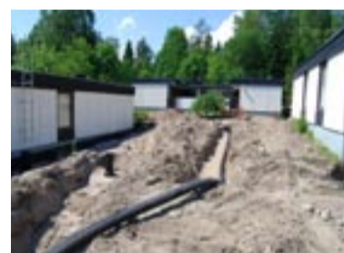
Pihatyötkin Tapiolan linjasaneeraustyömaalla on saatu päätökseen eikä vuoden takaisesta myllerryksestä ole jäljellä kuin valo- ja muistikuvia.
